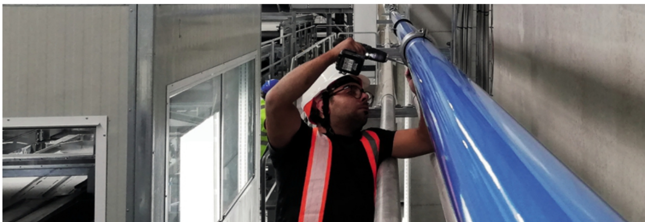
Rete distribuzione aria compressa
