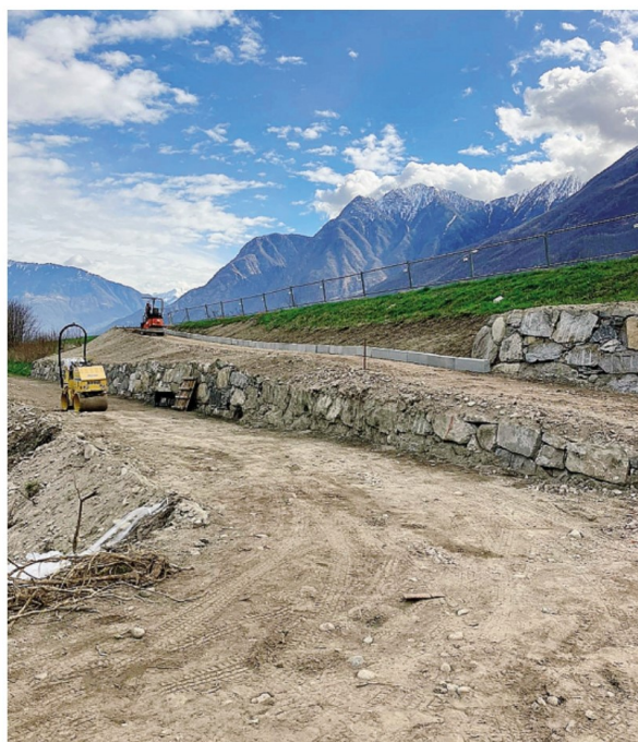
La nuova bretella di collegamento con la pista ciclopedonale a Gordona: lavori ormai a buon punto
