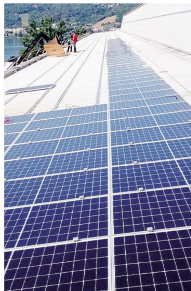
I pannelli sulla sede produttiva di Mab Metallurgica Alta Brianza
