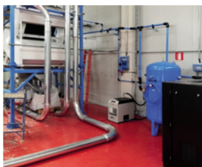
Stazione aria compressa in reparto
