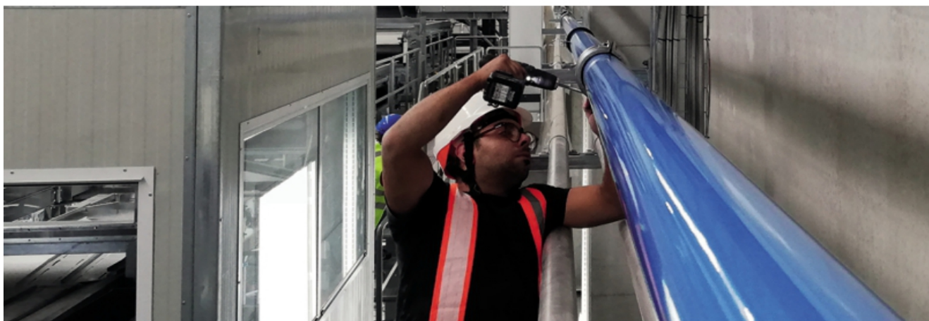
Rete distribuzione aria compressa
