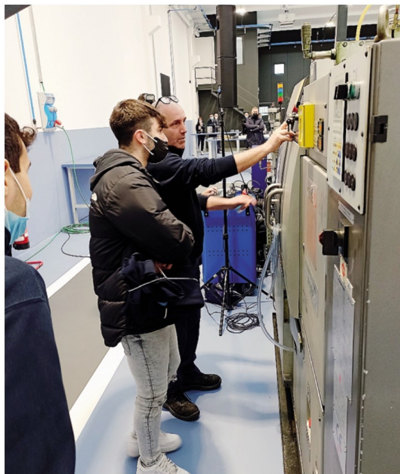
Alcuni impianti a disposizione degli allievi dell'academy della Torneria Colombo
