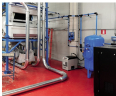
Stazione aria compressa in reparto
