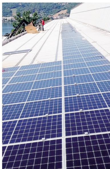
I pannelli sulla sede produttiva di Mab Metallurgica Alta Brianza
