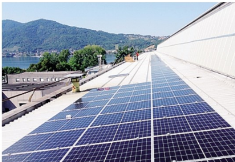
Il nuovo fotovoltaico dell'edificio di viale Brodolini
