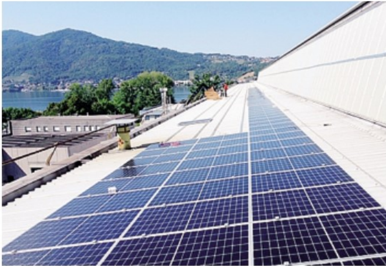
Il nuovo fotovoltaico dell'edificio di viale Brodolini
